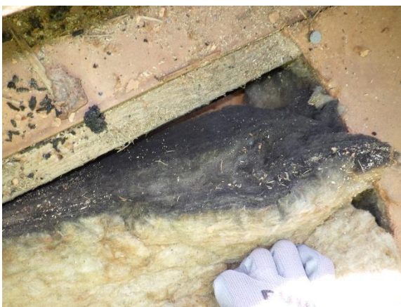
Rakennevauksen RA.04 puukoolauksen kohdalla villa tummunut
