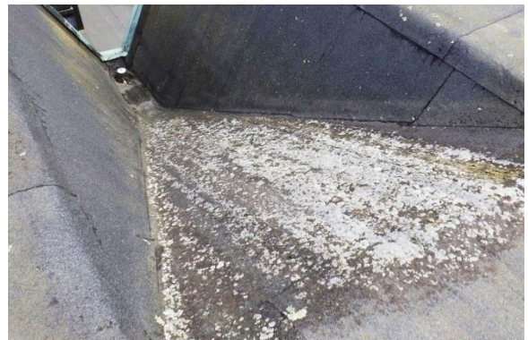
Kattokaivojen kallistuksissa pohjoispäässä yleisesti paljon jäkälää
