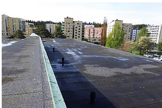
Pientä sadeveden lammikoitumista
