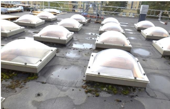
Vesikaton kattoikkunoiden läheisyydessä sammalkasvustoa ja lammikoitumista
