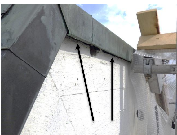
Reunapellitystä ei ole ulotettu riittävän alas julkisivulla, riskinä veden pääsy rakenteeseen
