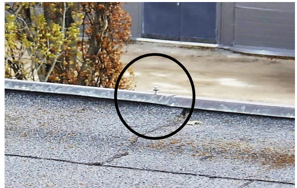
Reunapellytyksien kiinnityksissä yksittäisiä ylös-nousseita ruuveja
