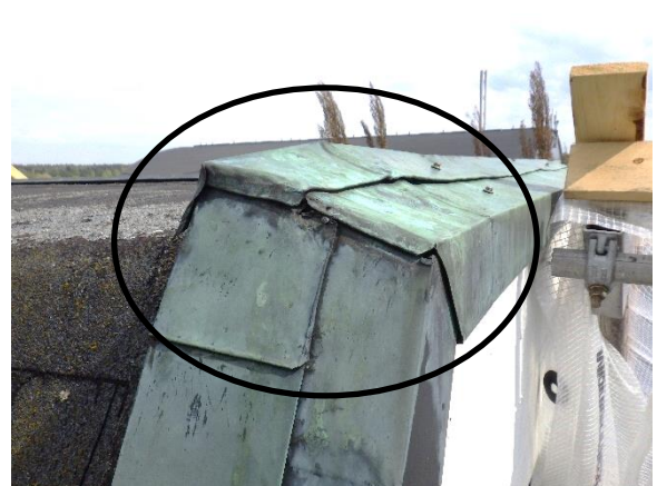
Reunapellityksien liitoksissa ja kiinnityksissä havaittiin puutteita
