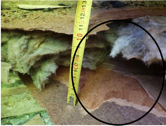
RA.04 höyrynsulku vain limitetty, kovalevyn mahdolliset kosteusvauriojäljet
