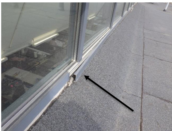
Aukivääntäytynyt ikkunan metallilista
