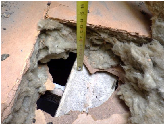
Rakenteessa ei havaittu höyrynsulkua. Laudoituksissa havaittiin betonivalun jäämiä
