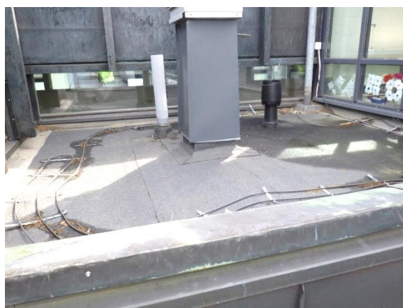
Kulma-alueella lämmityskaapeleihin oli kerääntynyt puiden neulasia
