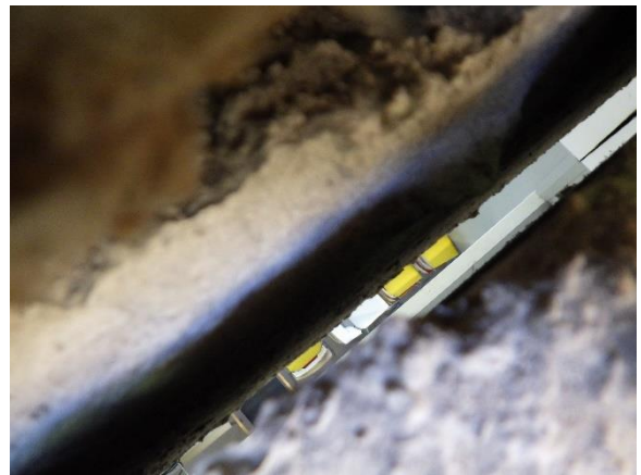
Rakennevauksen RA.05 selkeä ilmayhteys alapuolen luokkatilan sisäilmaan.
