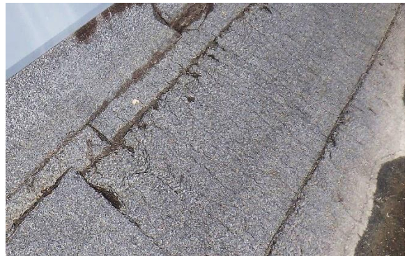
Bitumikermikatteen pinnalla havaittiin halkeilua
