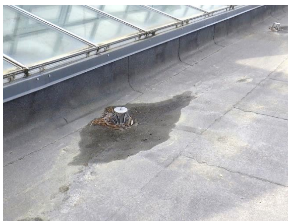
Kattokaivojen ympärillä paikoitellen puiden neulasia ja lehtiä
