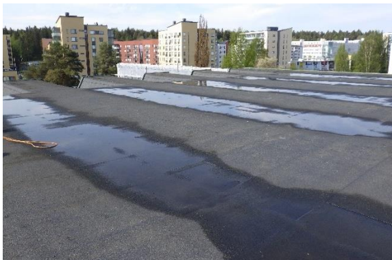
Sadevesi lammikoituu katolla eikä kulkeudu kattokaivolle
