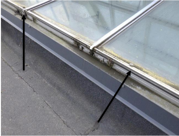
Pohjoispäädyn kattoikkunoissa likaantumista
