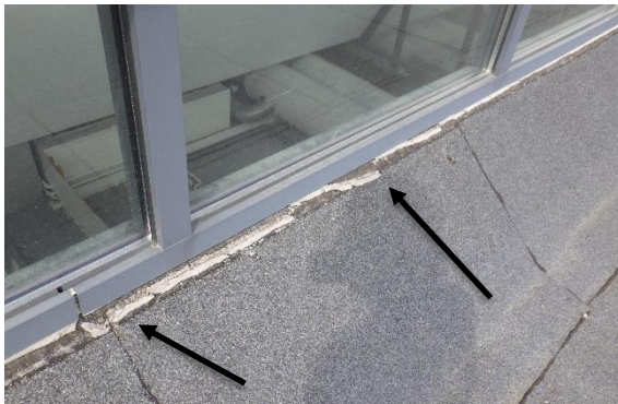
Reunanoston ja ikkunoiden liitoksen saumat epätiivaitä
