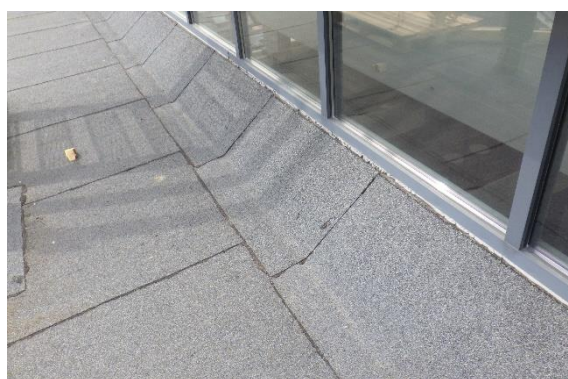
Reunanoston ja ikkunoiden liitoksen saumat epätiiviiitä
