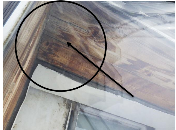
Nurkka-alueella kosteusvaurioitumisesta aiheutunutta puurakenteen lahovaurioitumista
