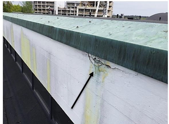
Reunapellitykset kastelevat betonijulkisivua, josta värjäytymää ja korroosiovaurioita
