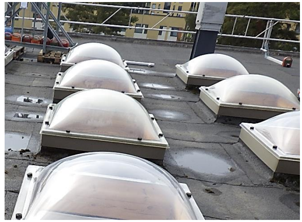
Pyöreäkuvullisissa kattoikkunoissa sisäpinnalla kosteusvaurioita
