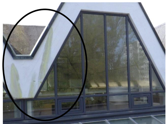
Ikkunajulkisivulla räystääspellitysten valuttaman sadeveden aiheuttamia vaurioita
