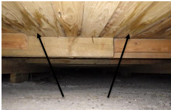
Rakenneavauksessa RA.07 ponttilaudoituksessa kosteusvauriojälkeä
